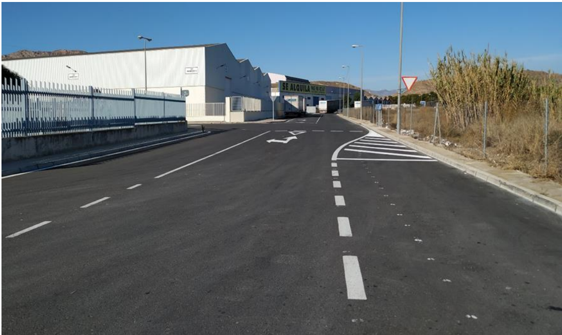
Fotografía 15. Pintura señalización longitudinal y transversal, calle Mistral. Fuente: Elaboración propia.
