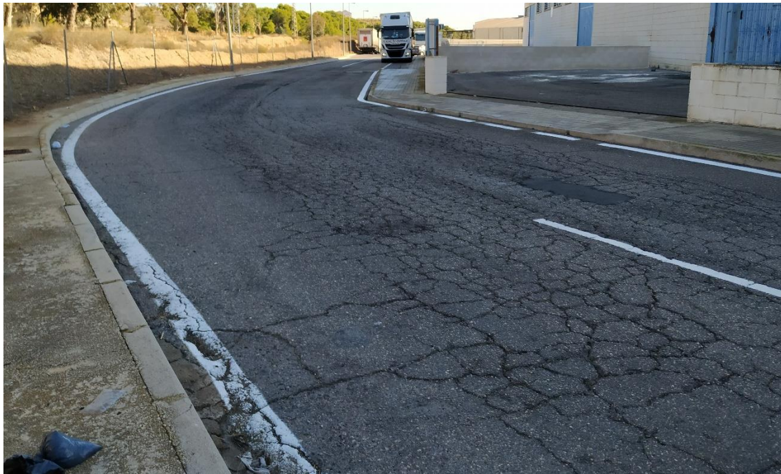
Fotografía 10. Ejemplo grietas significativas, tramo calle Mistral. Fuente: Elaboración propia.
