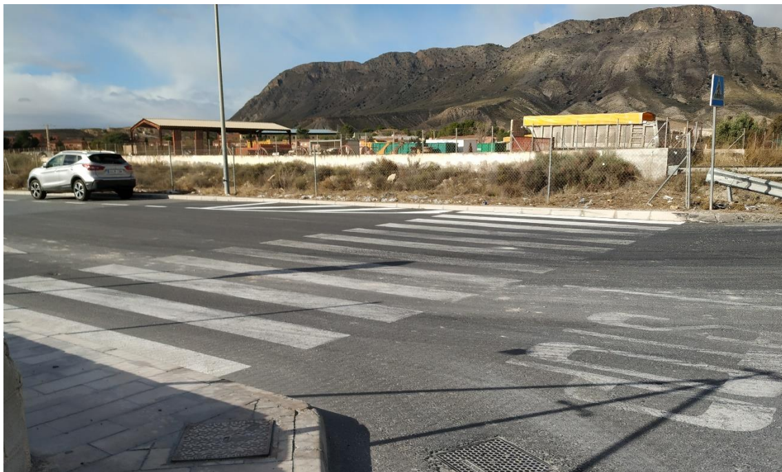
Fotografía 2. Desgaste pintura de paso de peatones, calle Mistral. Fuente: Elaboración propia.
