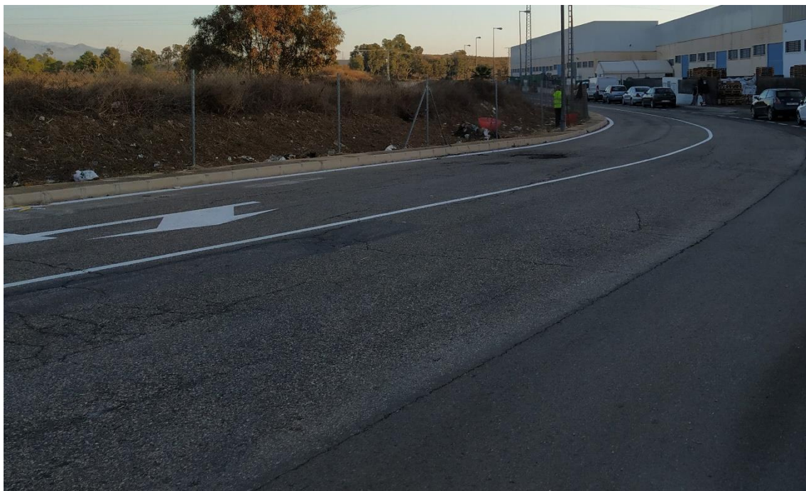
Fotografía 11. Ejemplo principio de agrietamiento, tramo calle Mistral. Fuente: Elaboración propia.
